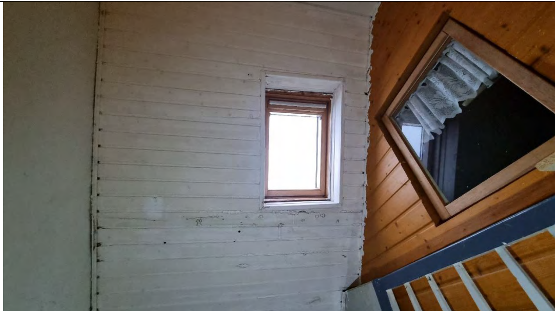
Dachfenster im Treppenhaus mit Wassereintritt bei Starkregen
