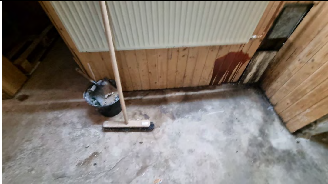
Hier im zentralen Kellerraum auch eine Wassereintrittsstelle
