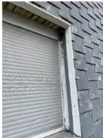
Nisthöhle im Fensterrahmen auf der Südseite
