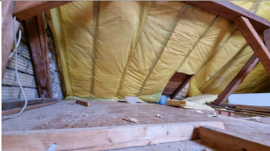
entfernte Dämmung an der Stelle des reparierten Dachschadens Westseite
