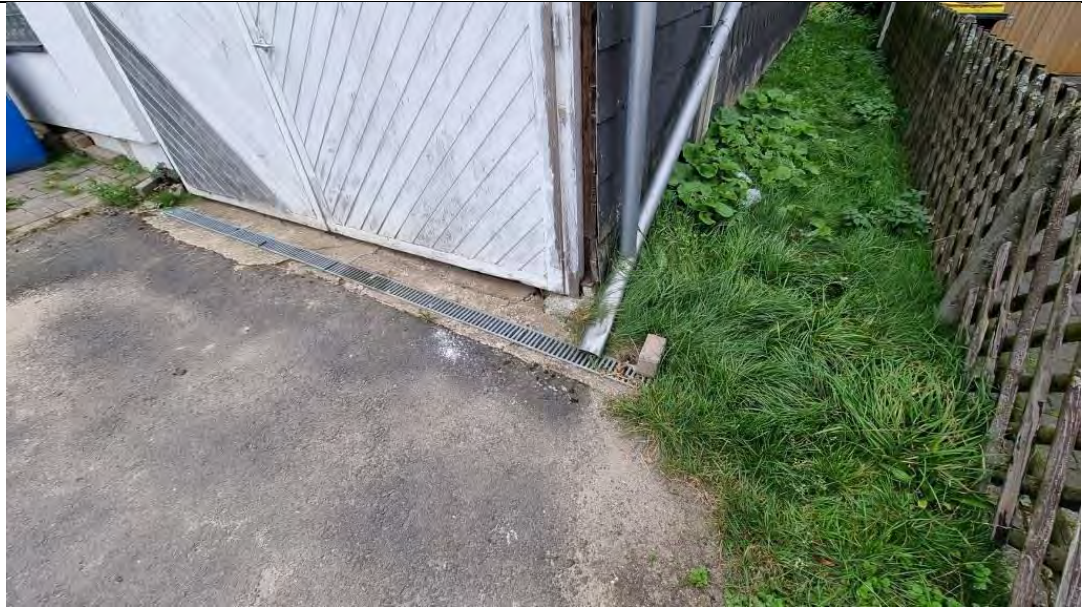
Regenentwässerung in Entwässerungsrinne
