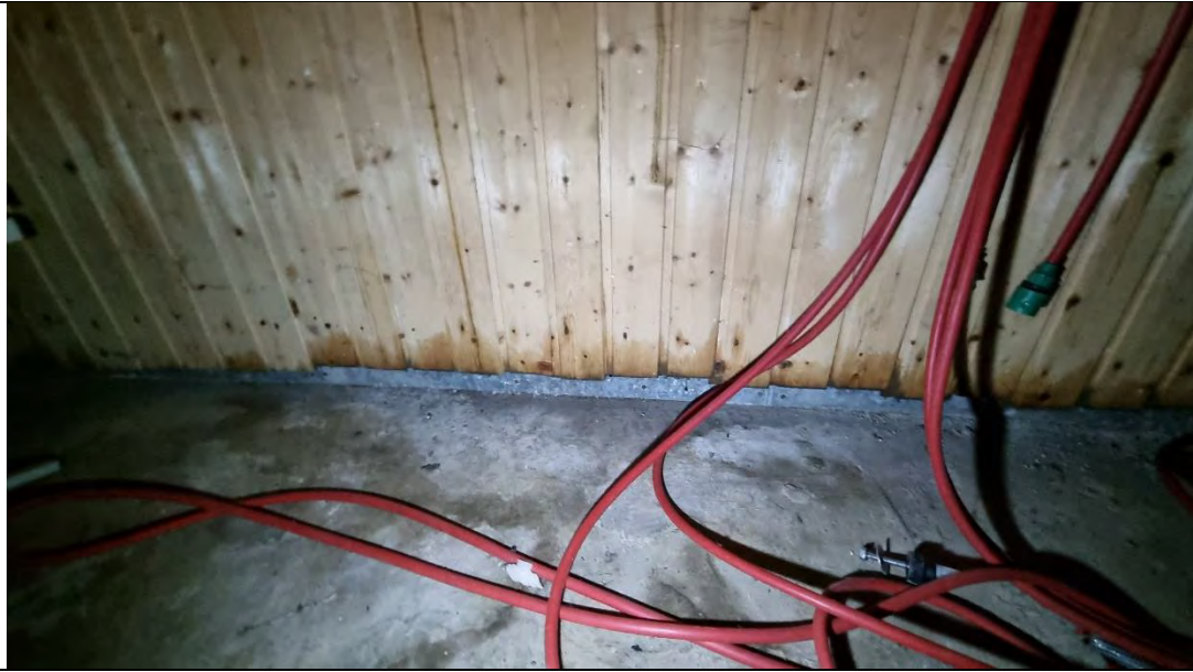
Südseite mit Nässe Spuren an der Wandverkleidung
