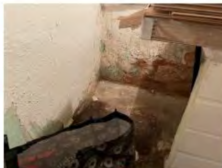
Feuchtigkeitseintritt im Baderaum
