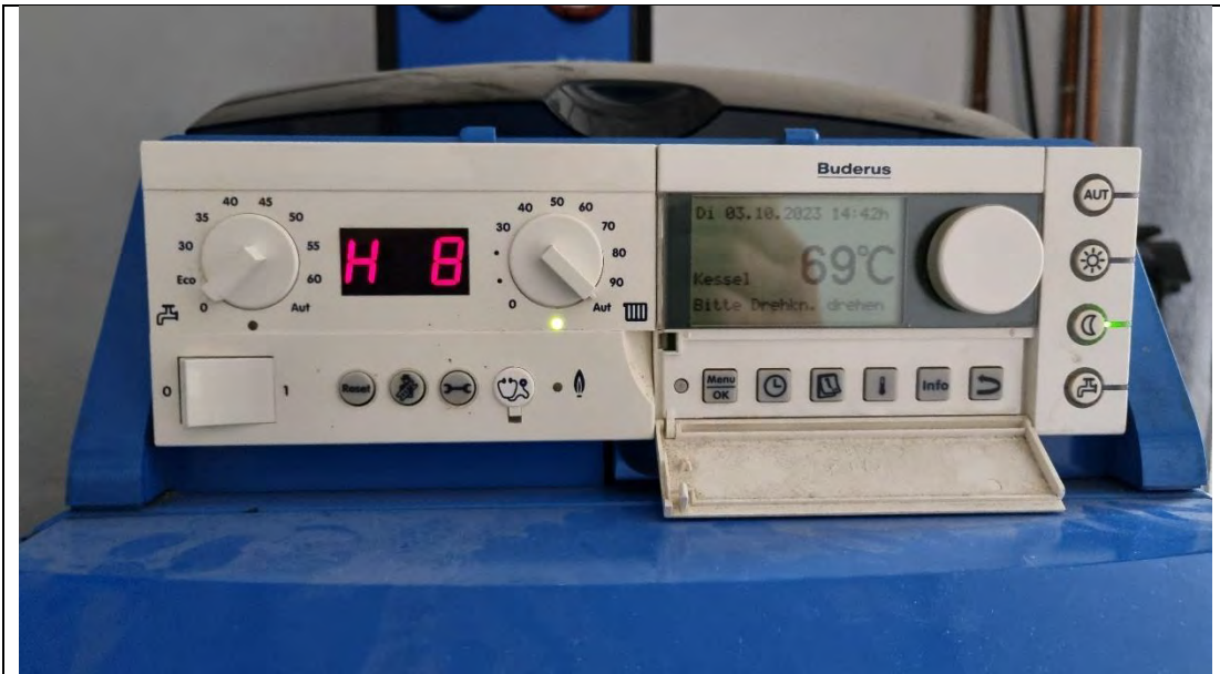
Warmwasser aus, Heizung auf Frostschutz am Heizkörper
