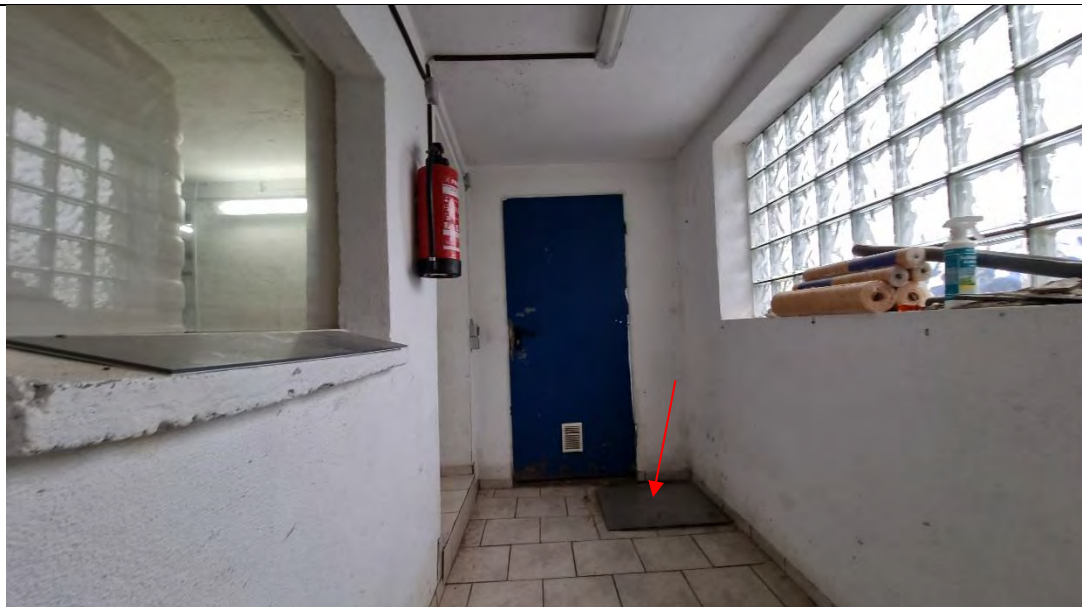
Links Heizungs- und Ölraum geradeaus Zugang zum Garagenvorraum Wasserzisterne unter dem Fußboden
