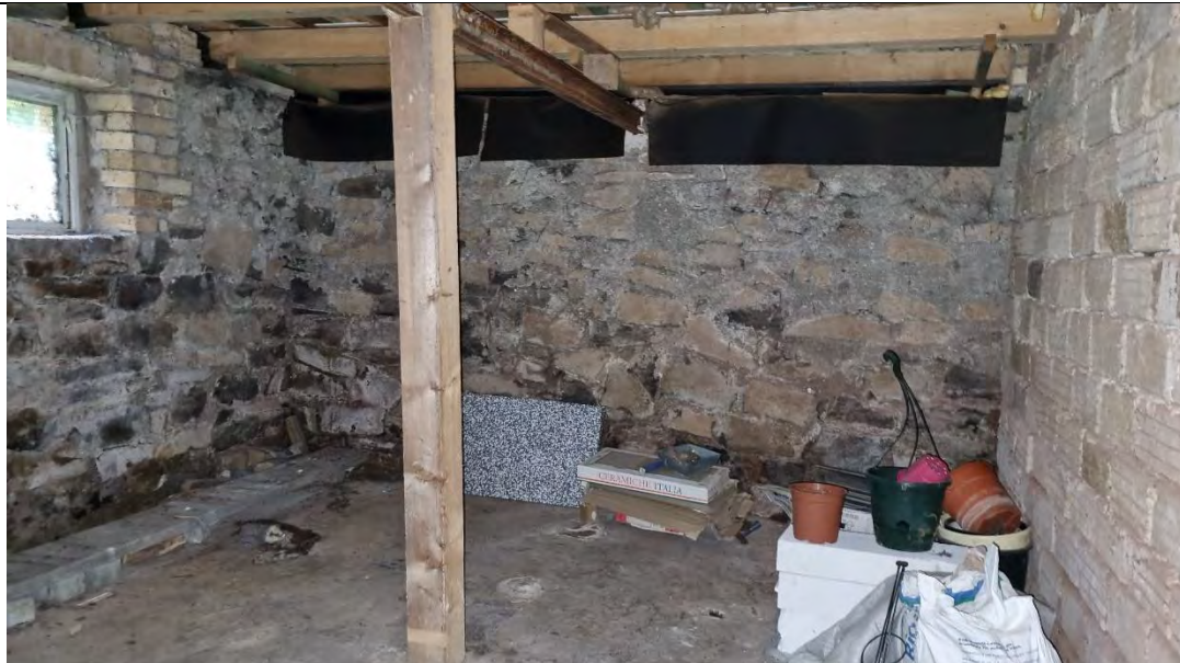
südwestlicher Kellerraum Südseite, auch hier Feuchteinfluss sichtbar
