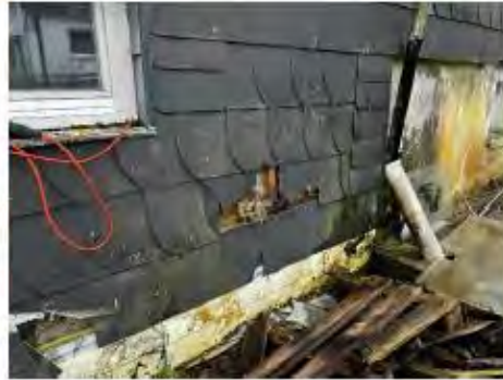
defektes Fallrohr und schadhafte Fassade auf Westseite
