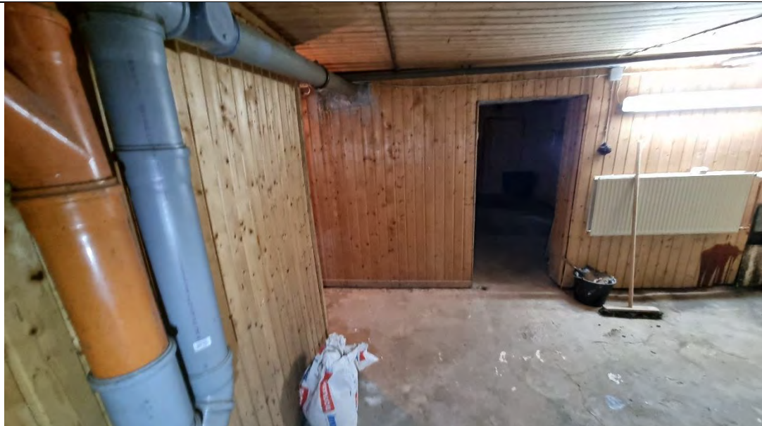
Kellerzentralraum - Blick nach Süden
