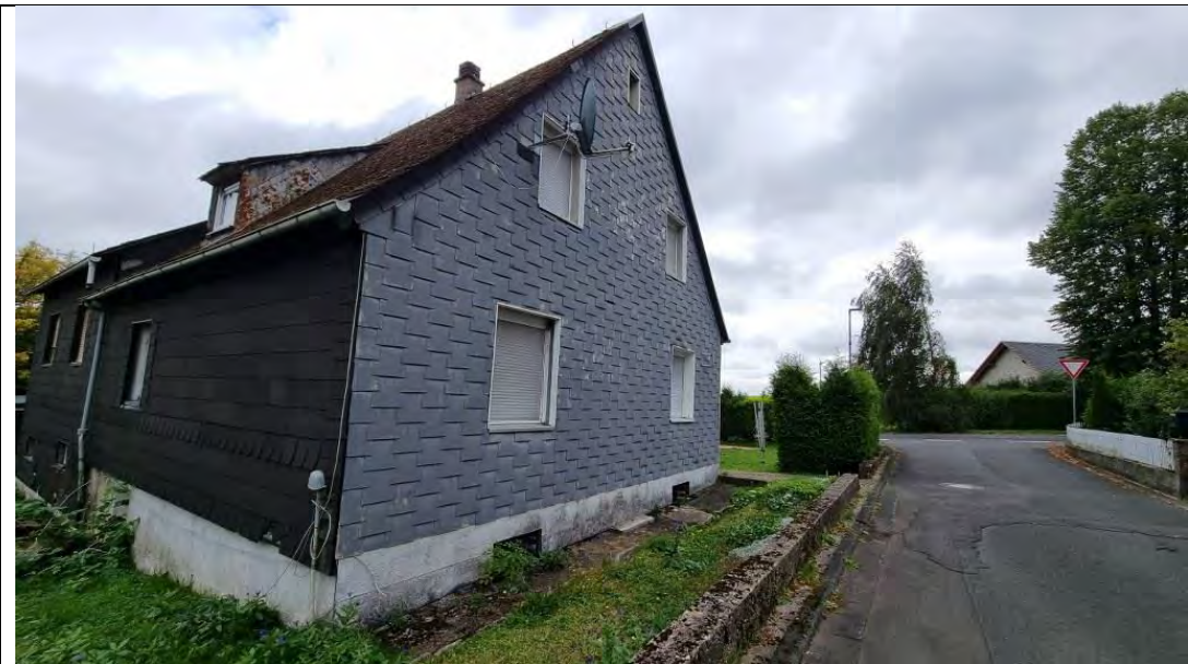
schadhafte Schiefereindeckung an der Dachgaube
