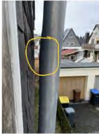
geplatztes Fallrohr neben Terrasse an der Nordseite, vermutlich infolge Verstopfung und Frost
