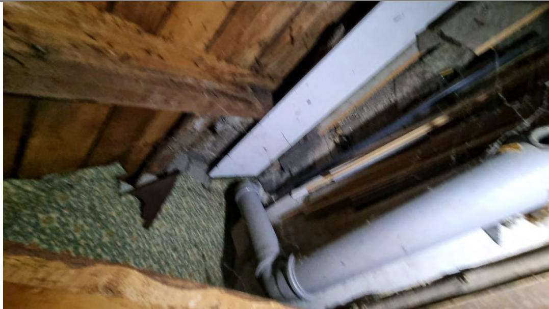
Abwasserleitung im Drempelraum neben der Küche
