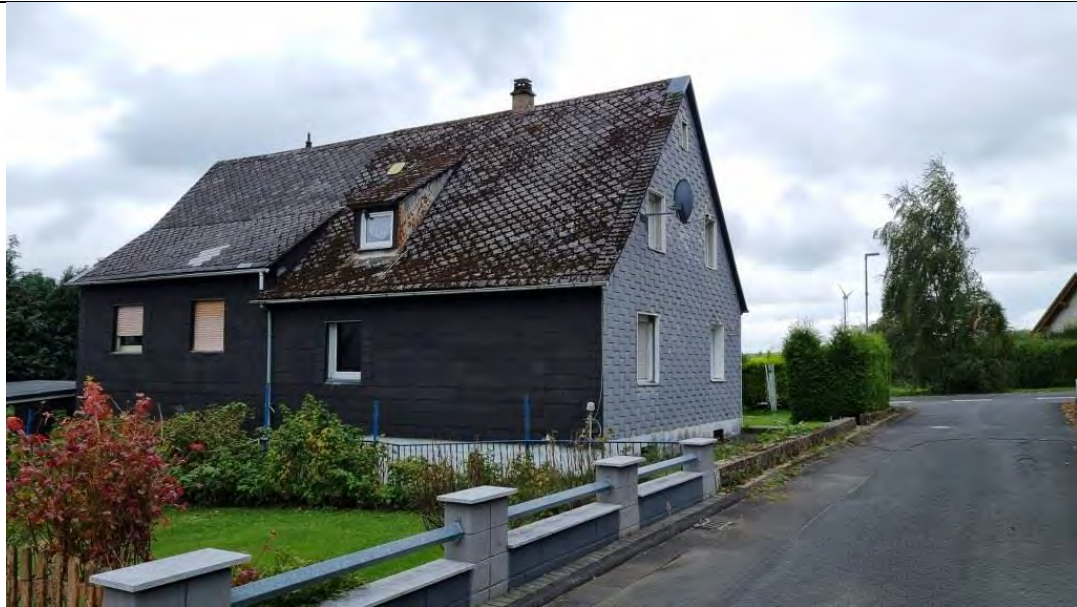
Hausansicht von Südwesten älter Dachteil stark vermoost
