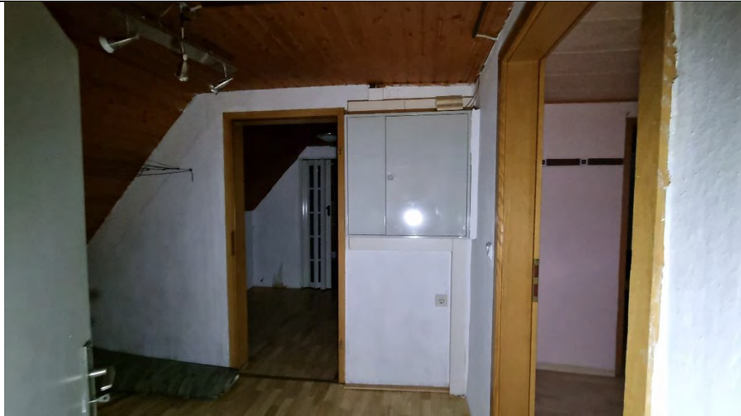
Zählerschrank im oberen Flur
