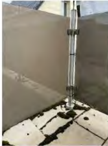
defektes Terrassengeländer, defekte Fliesen
