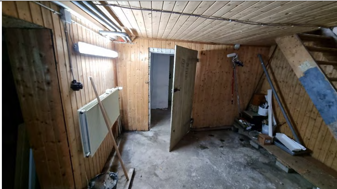
Kellerzentralraum - Blick nach Westen
