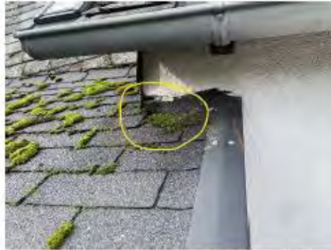
undichtes Dach am Übergang Nordteil zu Überdachung des Hauseingangs
