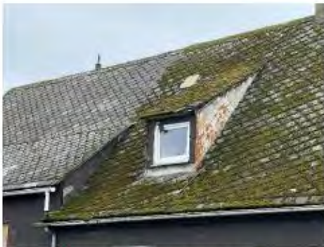
stark bemoostes Dach über Bauabschnitt 1, schadhafte Schiefereindeckung an der Gaube
