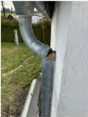
defektes Fallrohr neben Terrasse
