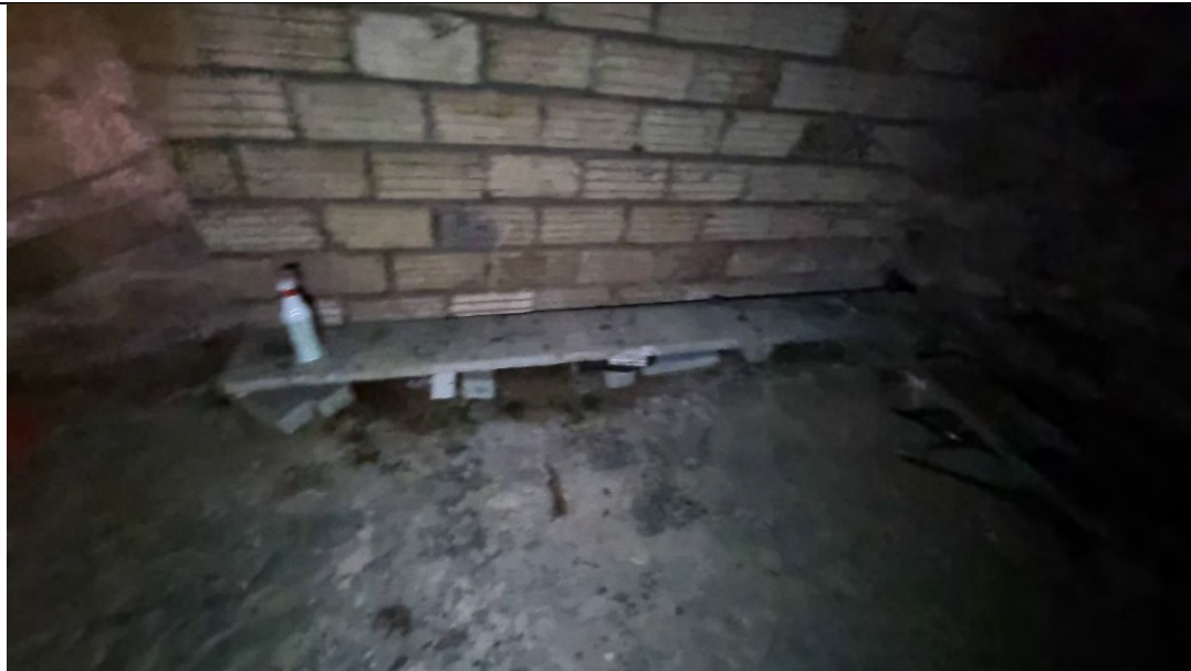
Abstellflächen höhergelegt wegen gelegentlichem Wassereintritt im Keller
