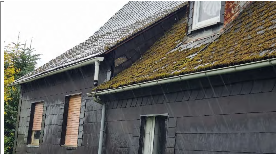
überlaufende verschmutzte Dachrinne an der Westseite
