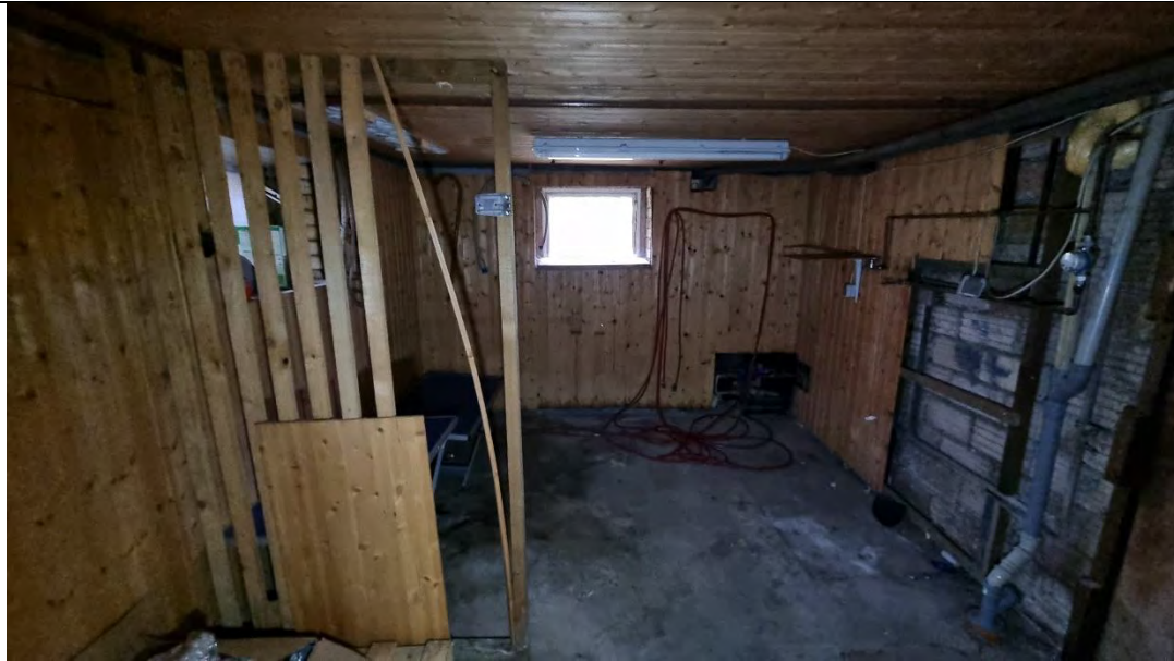
Keller Südostrraum, Wasserzähler hinten rechts
