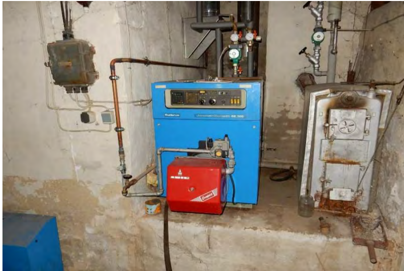
Gasheizung im Keller
