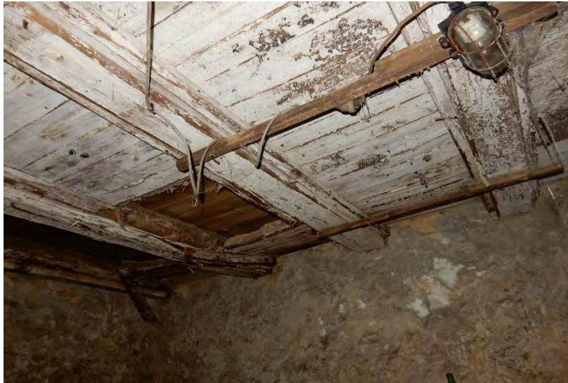
Kellerdecke, stark beschädigt
