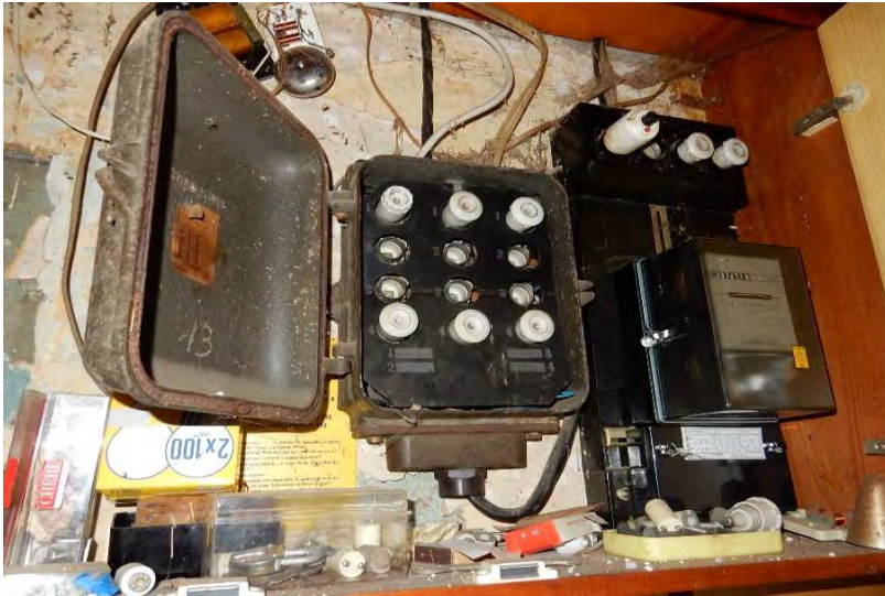
Stromzähler und Sicherungen im Flur, EG
