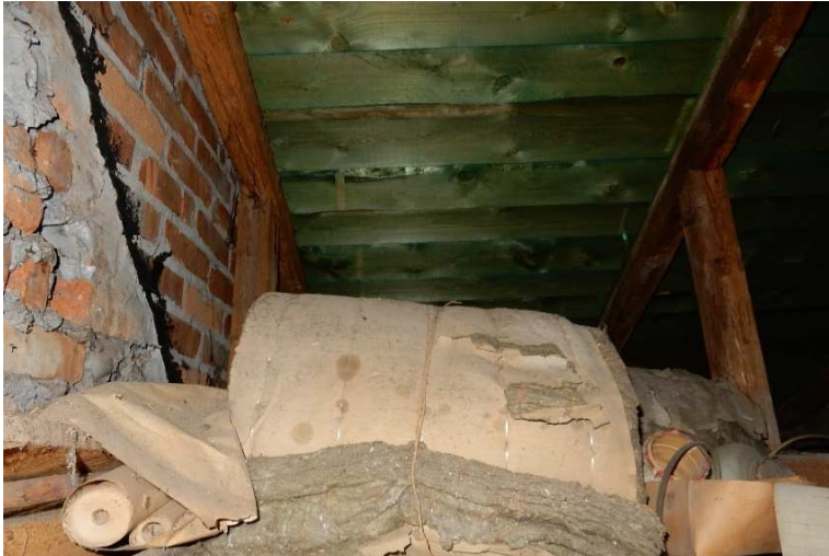
Dachboden, Reste von Mineralwolle
