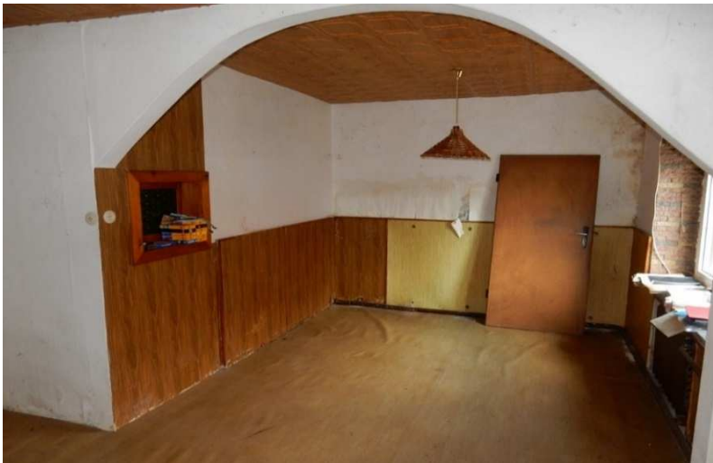
Wohnzimmer, EG Fußboden stark beschädigt (Durchbruchgefahr)
