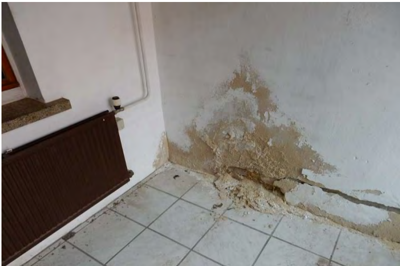
Durchgangszimmer zum Hof (Feuchtigkeitsschäden)
