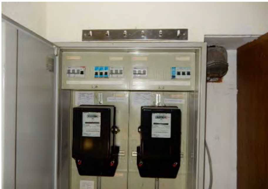
Stromkasten im Erdgeschoss Nebenhaus
