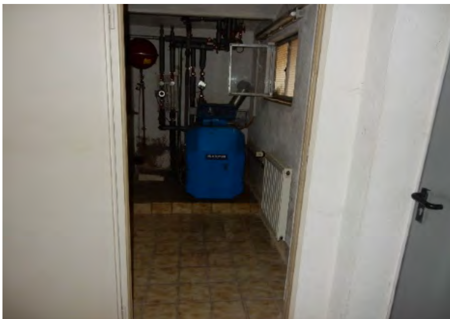
Heizungsraum im Neben- gebäude Heizung ist für das Gesamt- gebäude Ölheizung mit Öltanks recht Tür zum Hofraum
