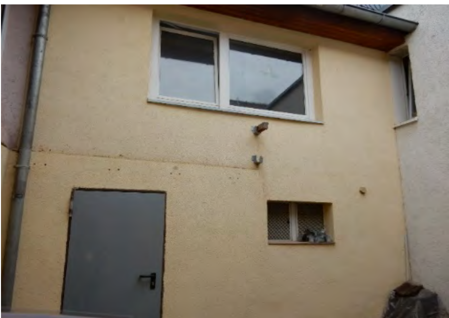
am Nebengebäude war ein Balkon angebaut, der jedoch abgerissen worden ist, teilweise sind die Halterungen noch vorhanden
