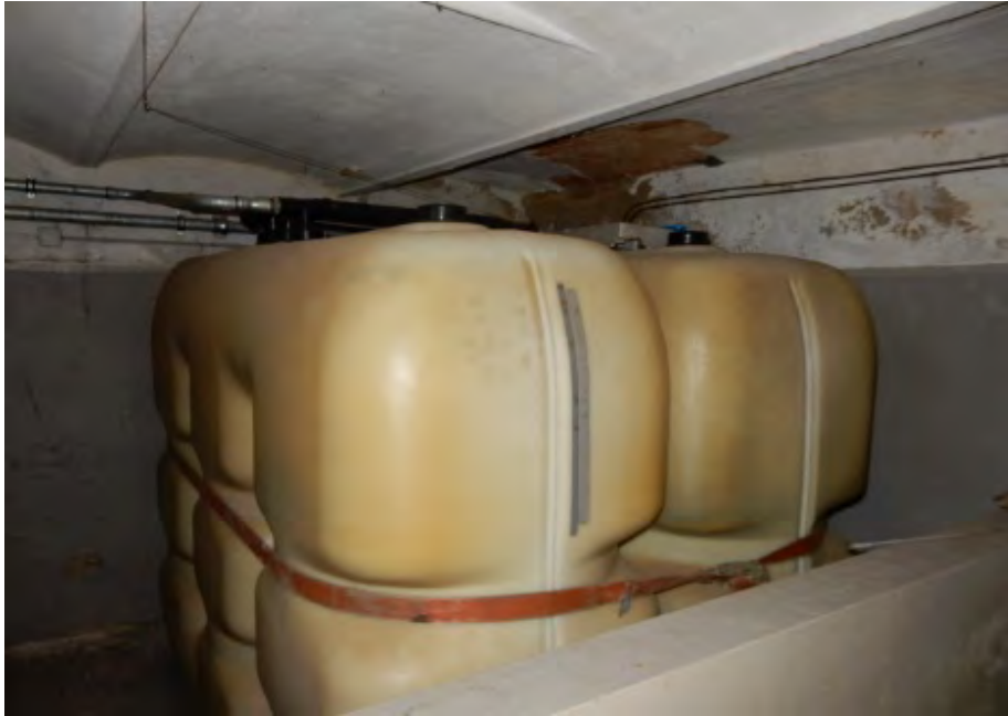
Öltanks im Heizungsraum
