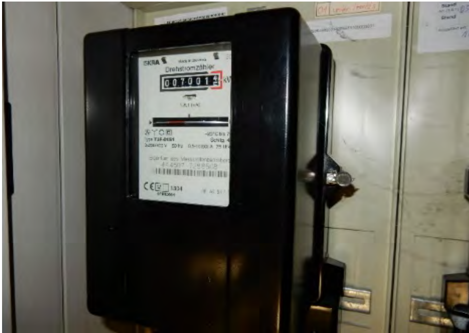
Stromzähler für die Wohnungen im Haupt- und Nebenhaus
