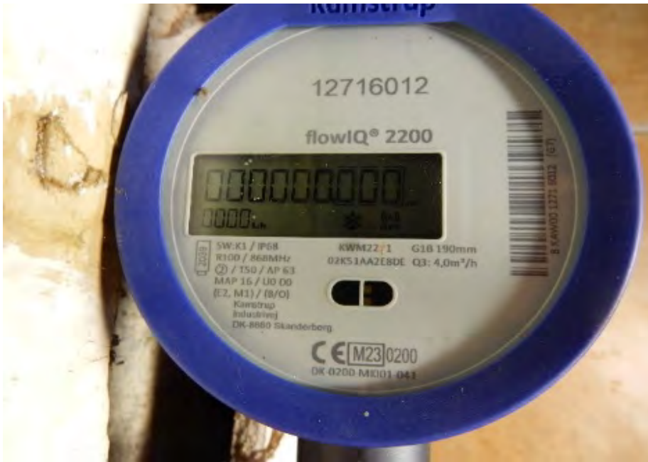
Wasseranschluss und Wasseruhr im Küchenbereich
