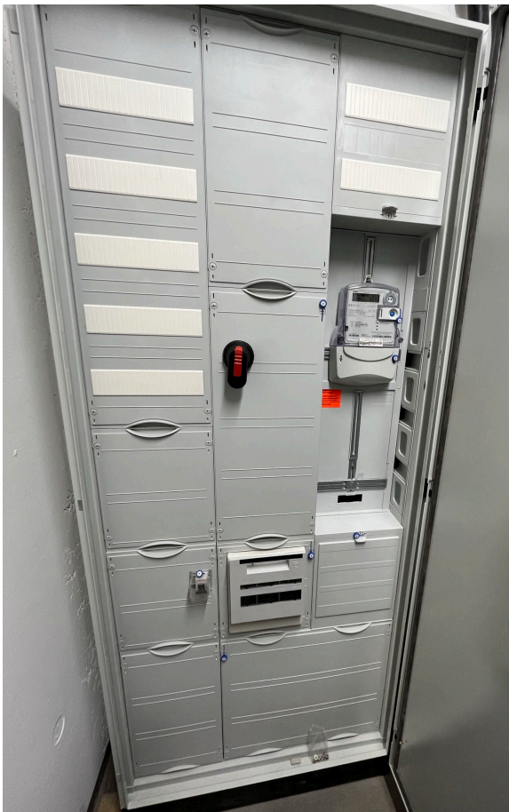
Abbildung 4: Zählerschrank im Technikraum (Quelle: Aufnahme BlmA)
