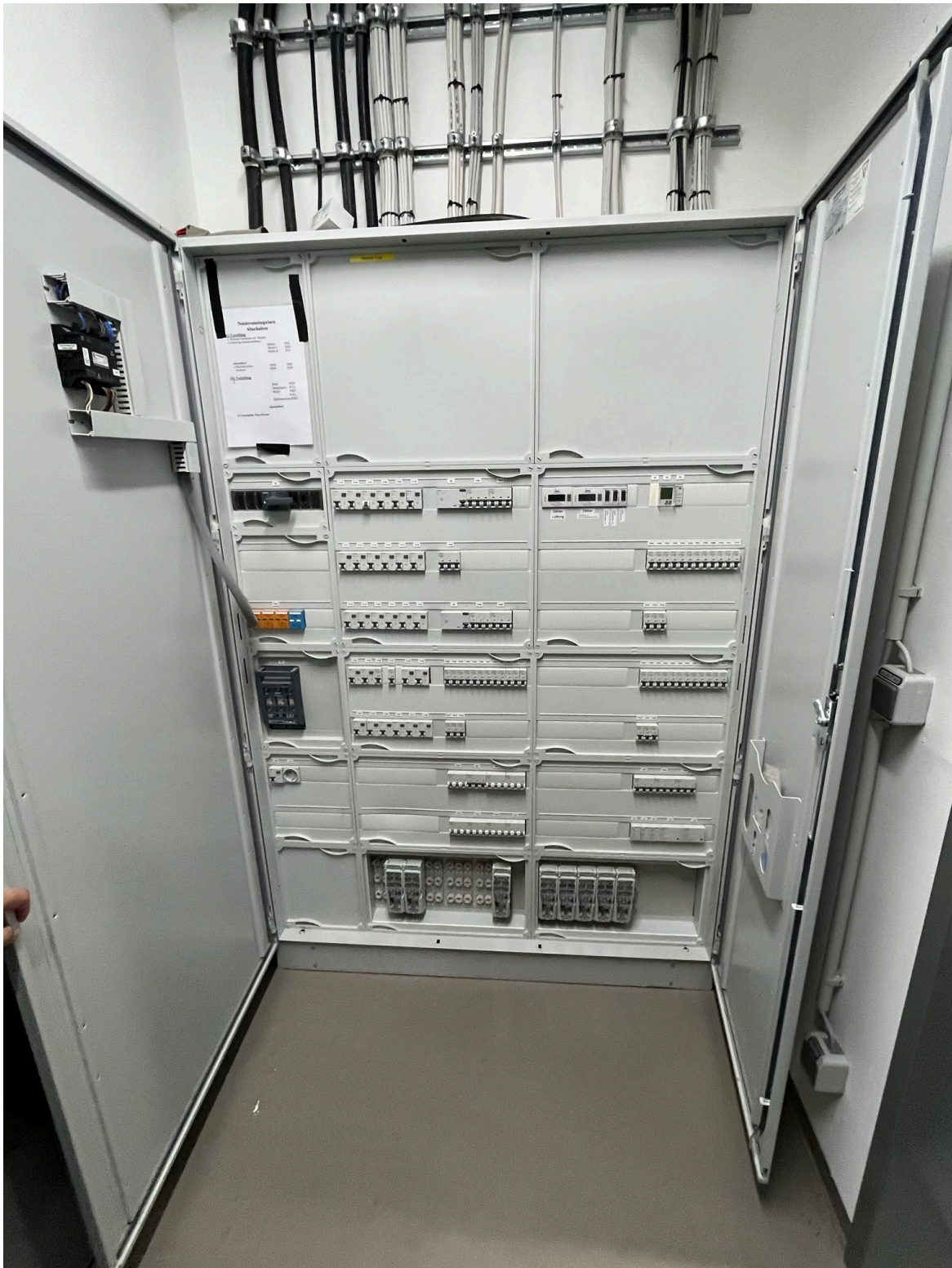
Abbildung 5: Niederspannungshauptverteilung im Technikraum (Quelle: Aufnahme BlmA)
