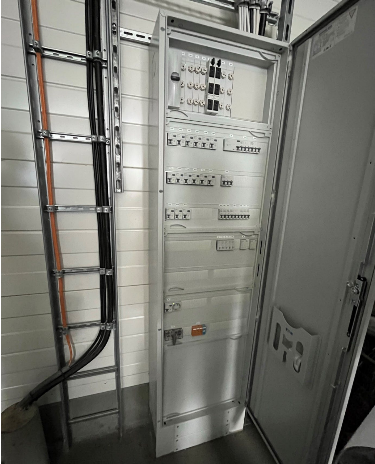
Abbildung 6: Unterverteilung KFZ-Halle (Quelle: Aufnahme BlmA)
