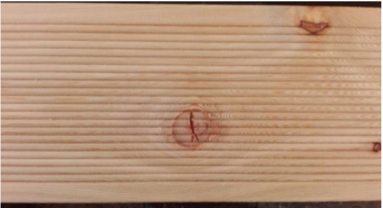
Foto 6 – ein aufgerissener, herausbröckelter Ast
