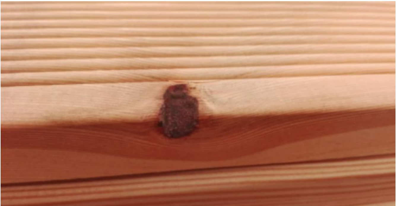
Foto 14 – ein seitlich gelegener, ausgefallener Ast
