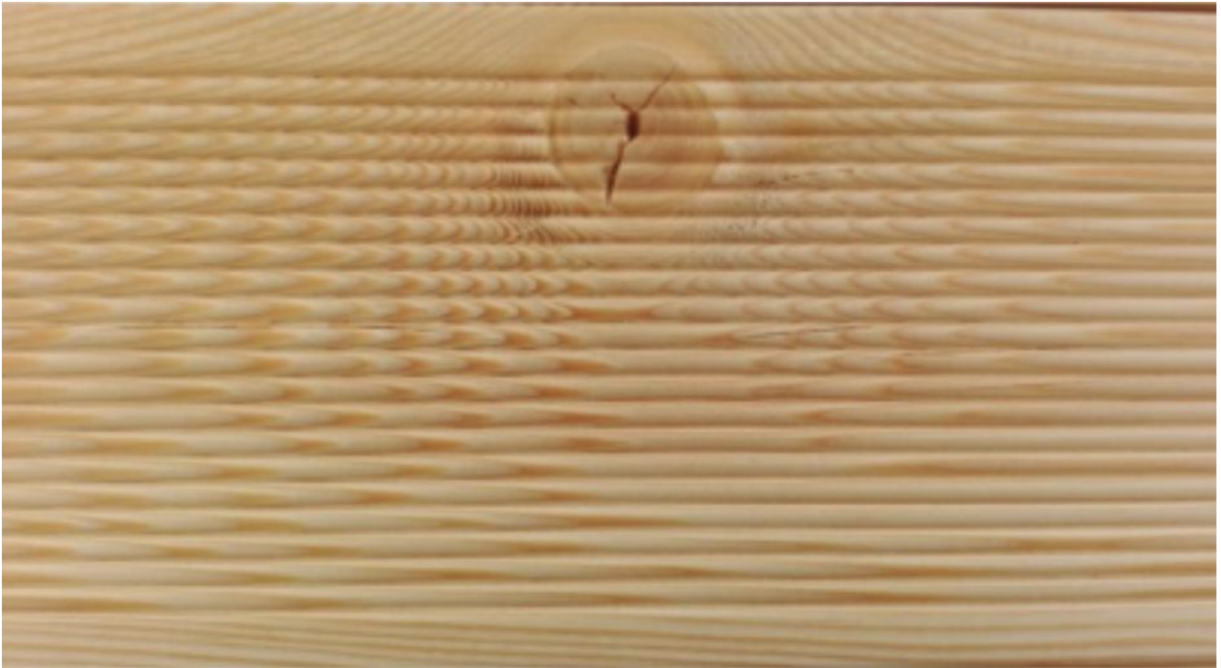
Foto 13 – ein aufgerissener, nicht herausbröckelnder Ast
